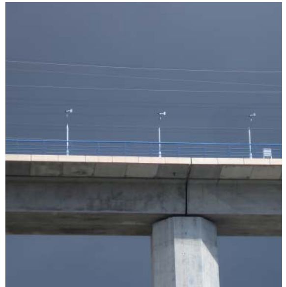
Estación de detección de viento lateral ubicada en viaducto.
