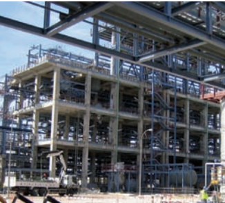
Ingeniería de detalle, Gestión de Compras y Construcción de Plantas LEXAN I, LEXAN II y HPP para la producción de Policarbonatos y Plástico de Altas Prestaciones (ULTEM®) para GE Plastics (hoy SABIC) en Murcia (España) Engenharia de detalhamento, Gestão de compras e Construção das Unidades LEXAN I, LEXAN II e HPP para a produção de policarbonatos e Plásticos de alto desempenho (ULTEM®) para a GE Plastics (atualmente SABIC) em Múrcia (Espanha)
