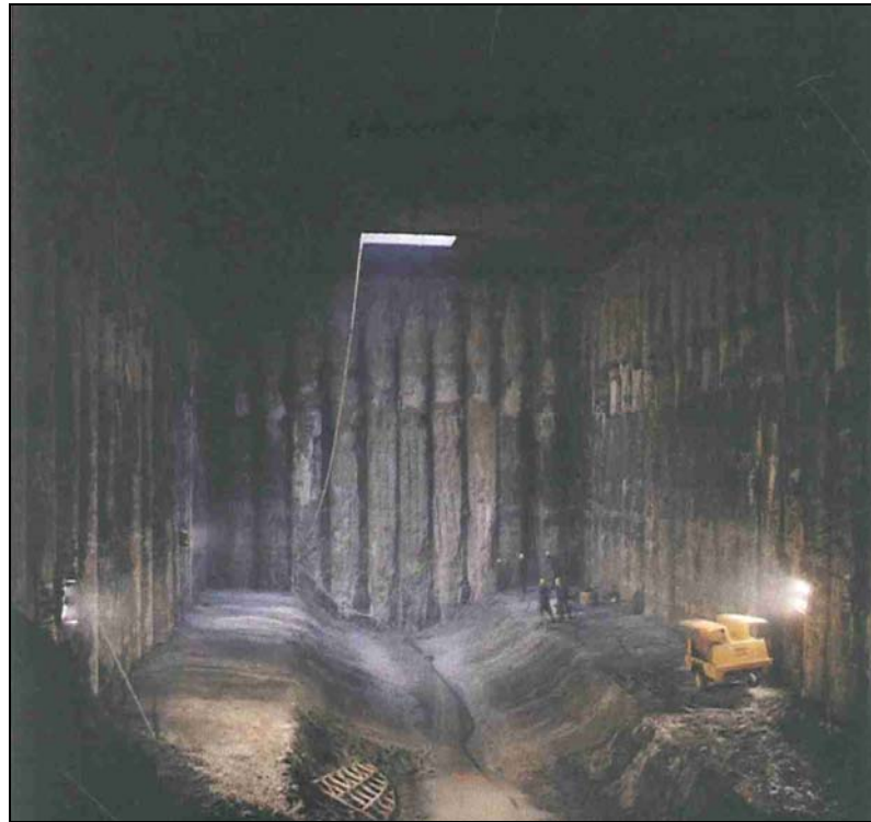
Recinto de pantallas en la Estación de El Casar
